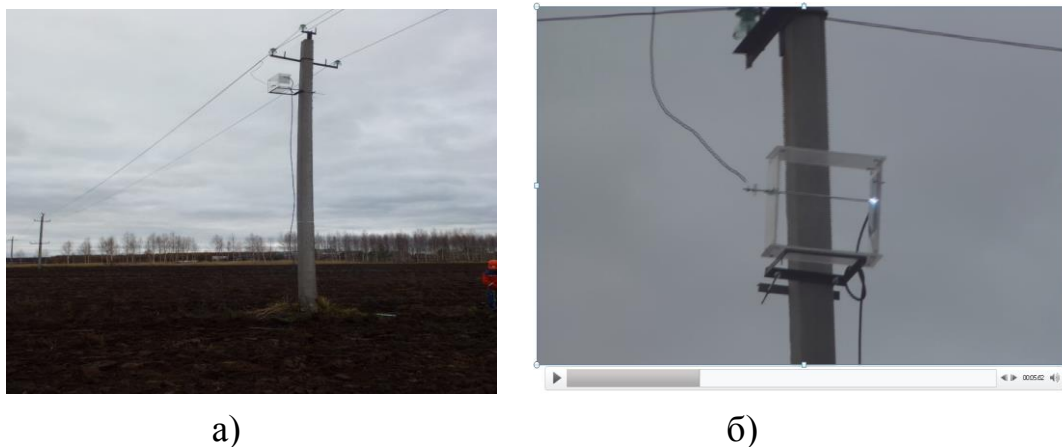
Рис. 10. Экспериментальная установка, смонтированная на промежуточной опоре ВЛ 10 кВ: а) общий вид; б) горение перемежающейся дуги
